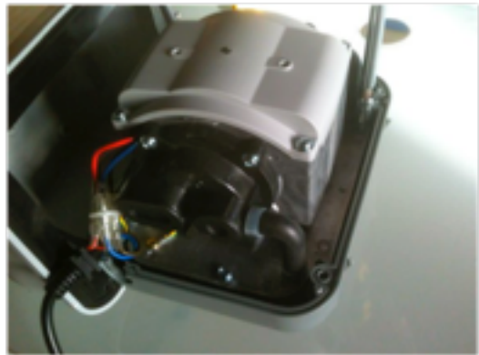
Résolution "BlomEpur" du problème de fuite interne en 2012 provoquant la casse prématurée des pompes à air Secoh/Bibus, là où le fournisseur de l'époque a attendu plus de deux (!!!) ans avant d'apporter une solution.
